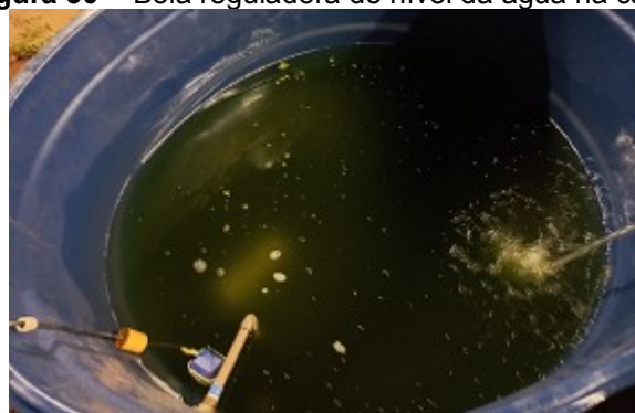
Figura 30 - Boia reguladora do nível da água na caixa
