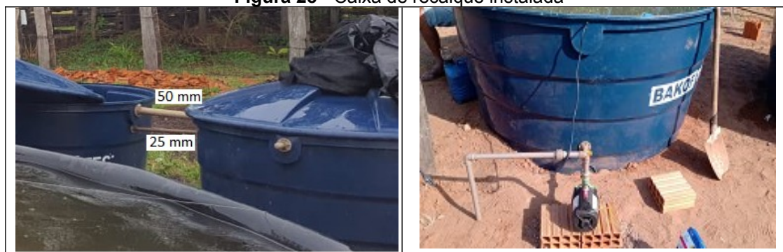
Figura 28 - Caixa de recalque instalada
