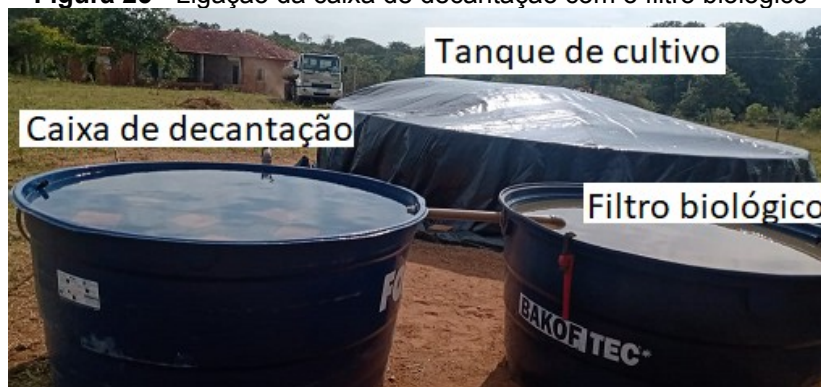
Figura 25 - Ligação da caixa de decantação com o filtro biológico
