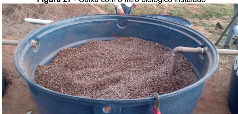
Figura 27 - Caixa com o filtro biológico instalado
