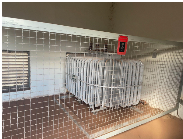
Figura 7 - Transformador da subestação campus Três Lagoas.
