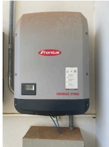
Figura 4 - Modelo de inversor de frequência da primeira usina instalada.
