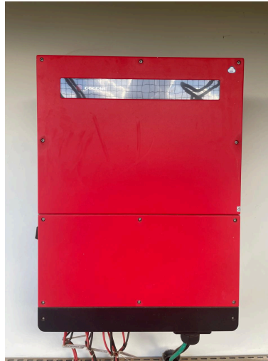
Figura 5 - Modelo de inversor de frequência da segunda usina instalada.
