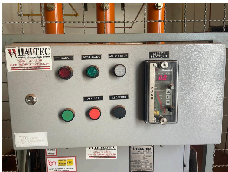
Figura 3 - Relé de proteção da subestação.
