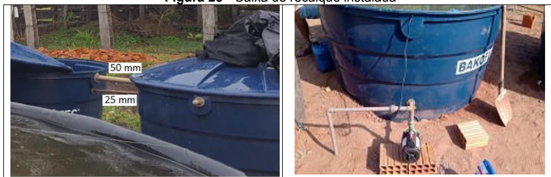
Figura 28 - Caixa de recalque instalada
